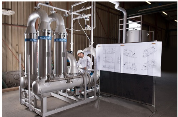
Équipement industriel et ingénierie de procédés : skid de filtration
